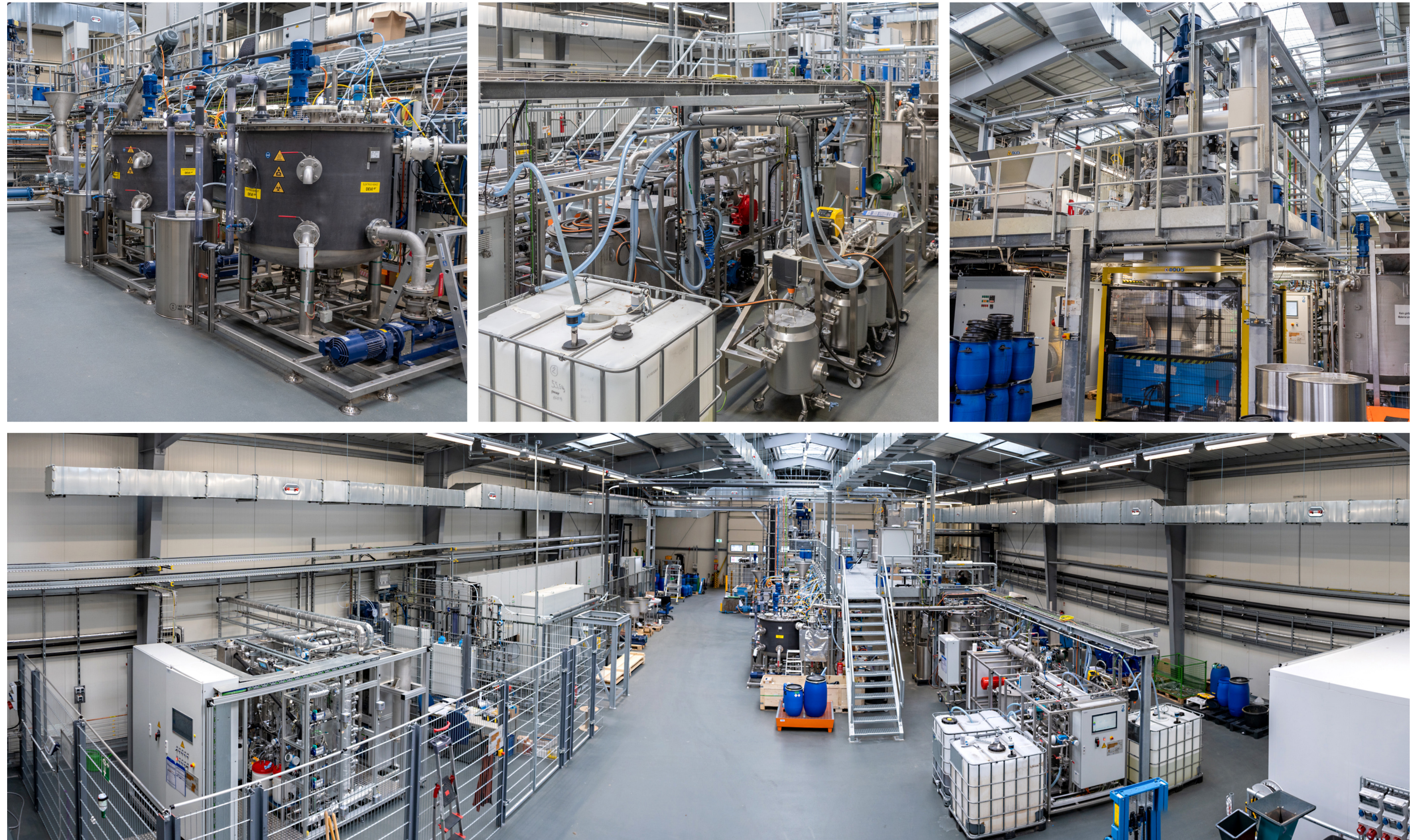
Abb. 4-21 Pilotanlage des Projekts „Pilot-SBG“
