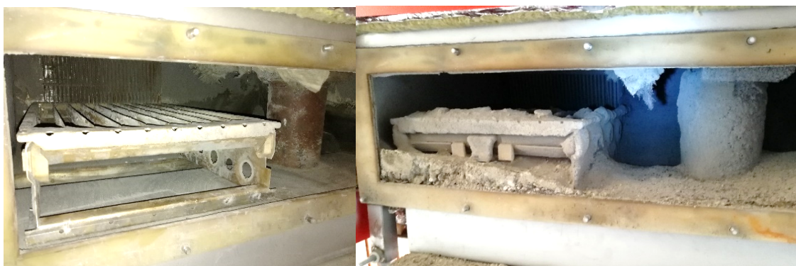
Abbildung 52: Leitblech im Staubbunker des ESP an der Kessel-Feldanlage und weiterhin ein Abscheiderrohr abgedeckt
