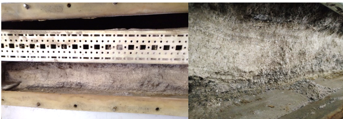
Abbildung 58: Schichtweise Ablagerung in der Beruhigungszone des Staubbunkers
