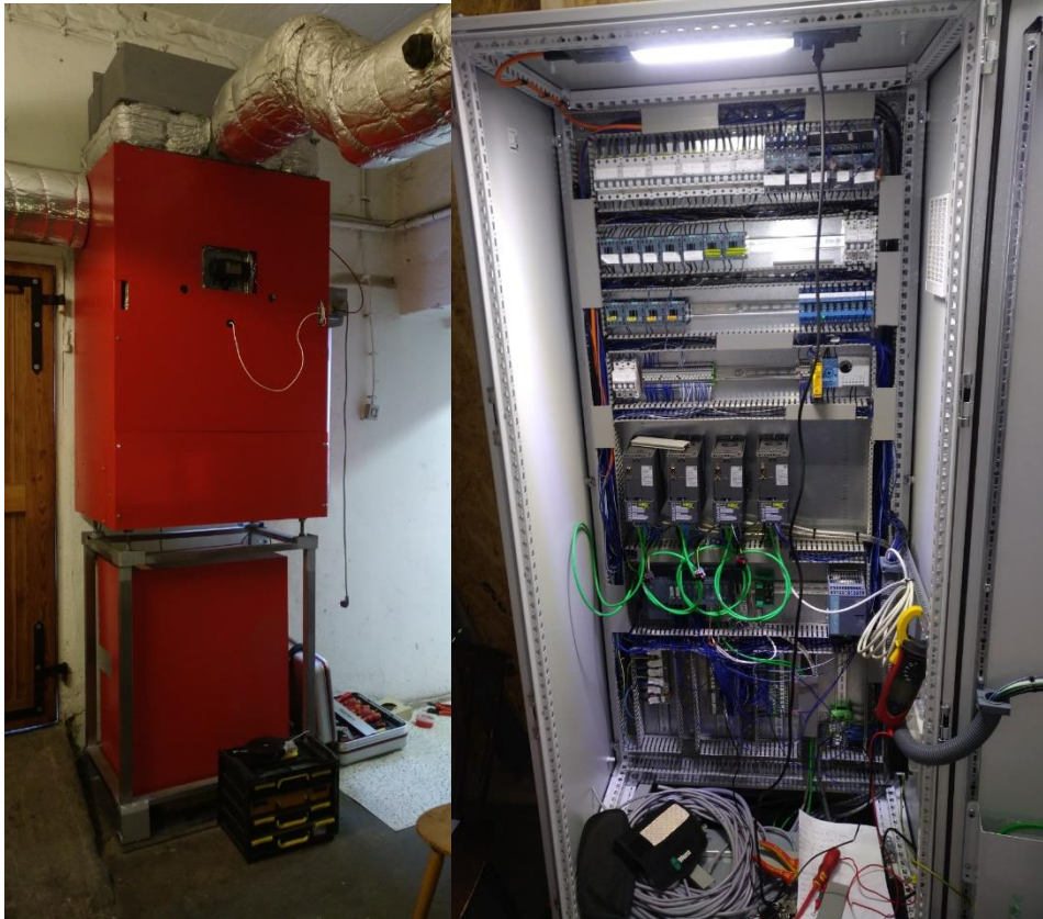
Abbildung 6: Installierter ESP und Installation der SPS
