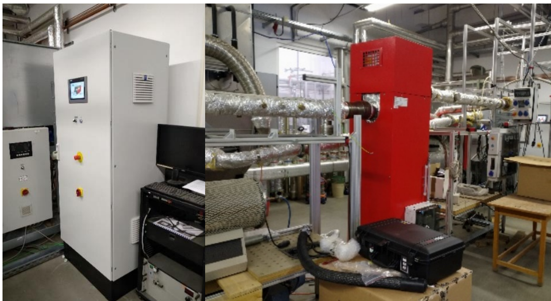
Abbildung 42: Installation von SPS und ESP im Technikum in Leipzig
