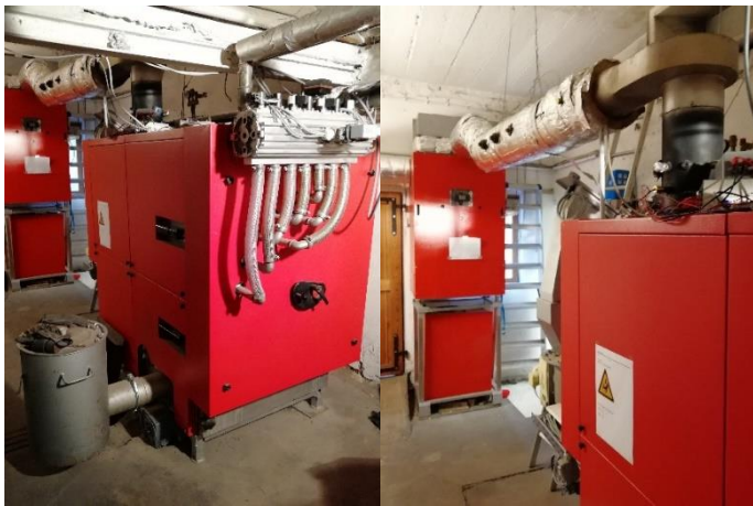
Abbildung 39: ÖKOTHERM®-Feldanlage und Abgasmesstrecke vor dem ESP
