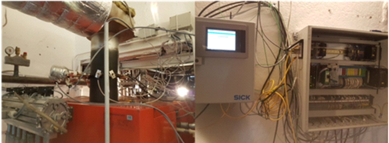
Abbildung 8: Monitor und Sensoren an der Feldtest-Hackschnitzelanlage der Firma A.P. Bioenergietechnik in Hirschau. Links: Abgassensorik mit Verkabelung. Rechts: Feuerungsprozessmonitor Sick AG
