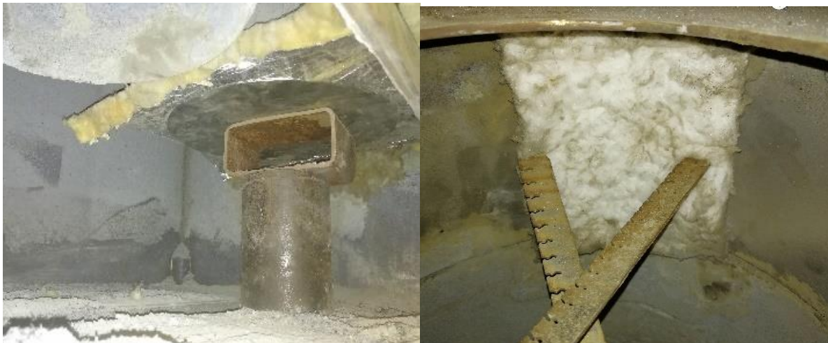
Abbildung 50: Blick in den unteren Bereich des ESP, ein Abscheiderrohr von unten abgedeckt und der Luftkanal von oben abgedichtet
