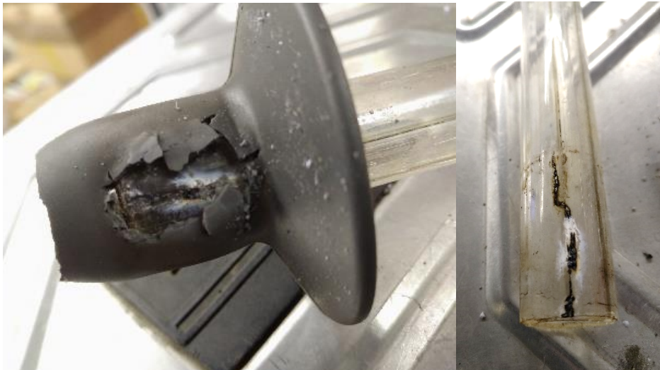
Abbildung 43: Schäden durch Kriechströme am Isolator des ESP
