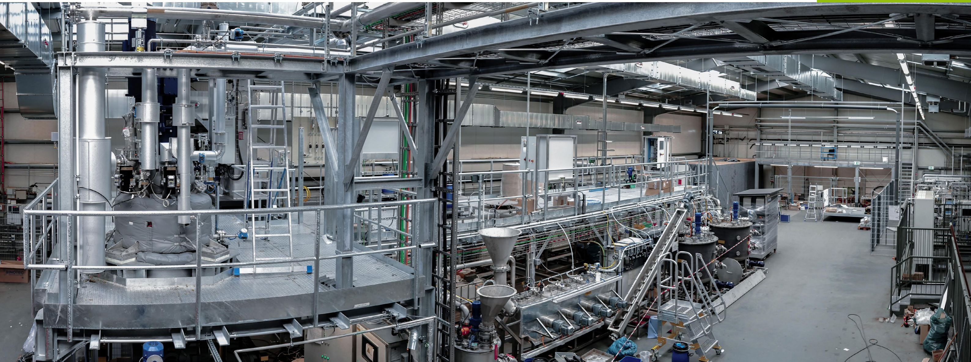
Abbildung 10: Pilotanlage zur Herstellung von erneuerbarem Methan auf dem Gelände des Deutschen Biomasseforschungszentrum gemeinnützige GmbH in Leipzig
