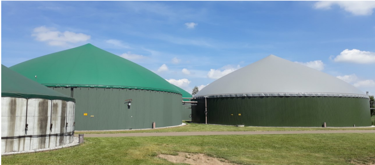
Abbildung 53: Ansicht Biogasanlage mit Güllebehälter, Fermenter und Nachgärer der Best-Case-Anlage 2 © DBFZ
