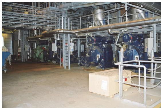
The pelletizing lines at Køge Biopillefabrik
