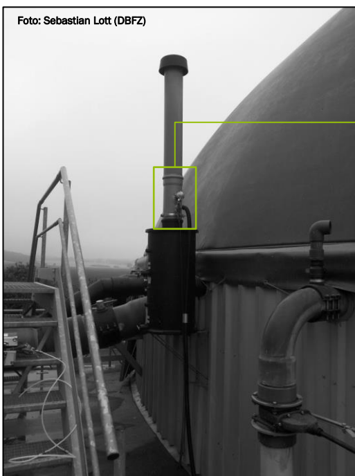
In der Überdrucksicherung installierte Auslöseerfassung
