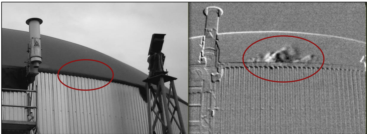
Abbildung 5-2: Methanemission aus einer Leckage am Übergang des Foliendachs zur Behälterwand
