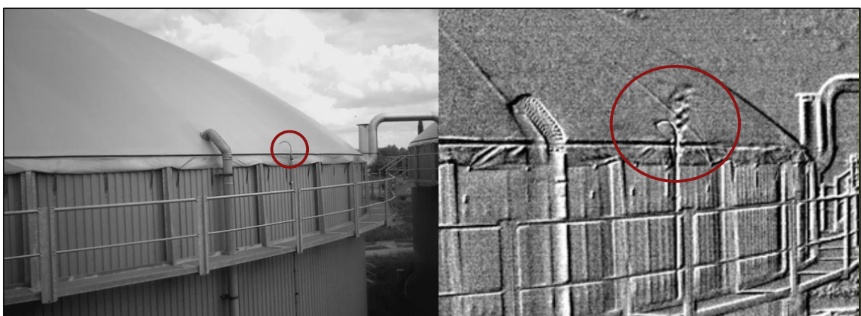
Abbildung 5-3: Methanemission aus einer Leckage an der Anzeige für den Biogasfüllstand
