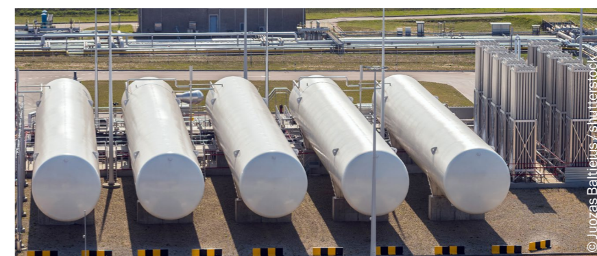
Abbildung 16: Lagertanks (bulk storage tanks) für LNG
