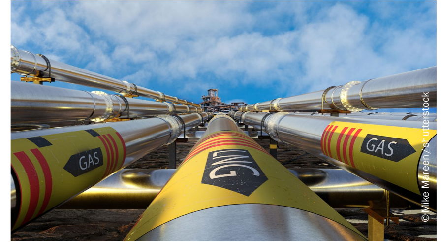
Abbildung 15: LNG- und Gaspipeline
