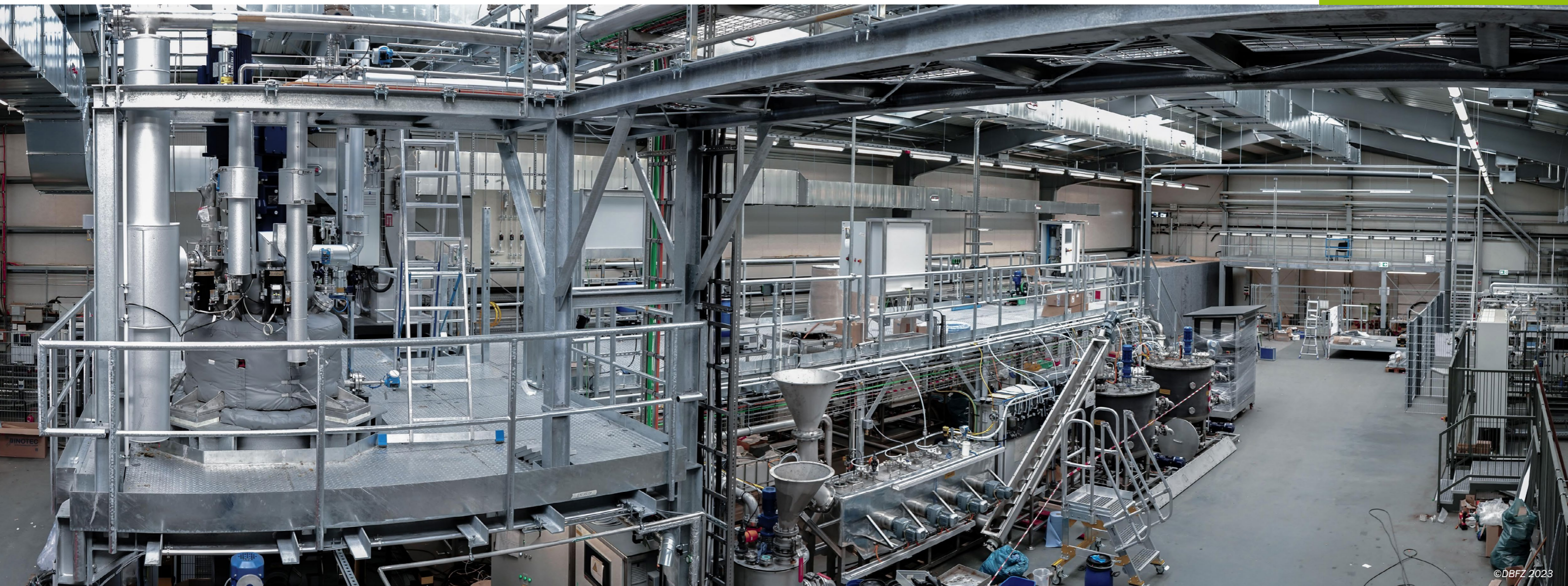
Abbildung 14: Pilotanlage zur Herstellung von erneuerbarem Methan auf dem Gelände des Deutschen Biomasseforschungszentrum gemeinnützige GmbH in Leipzig
