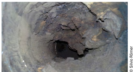
Abb. 8 Verkrustungen im Rauchgasweg
