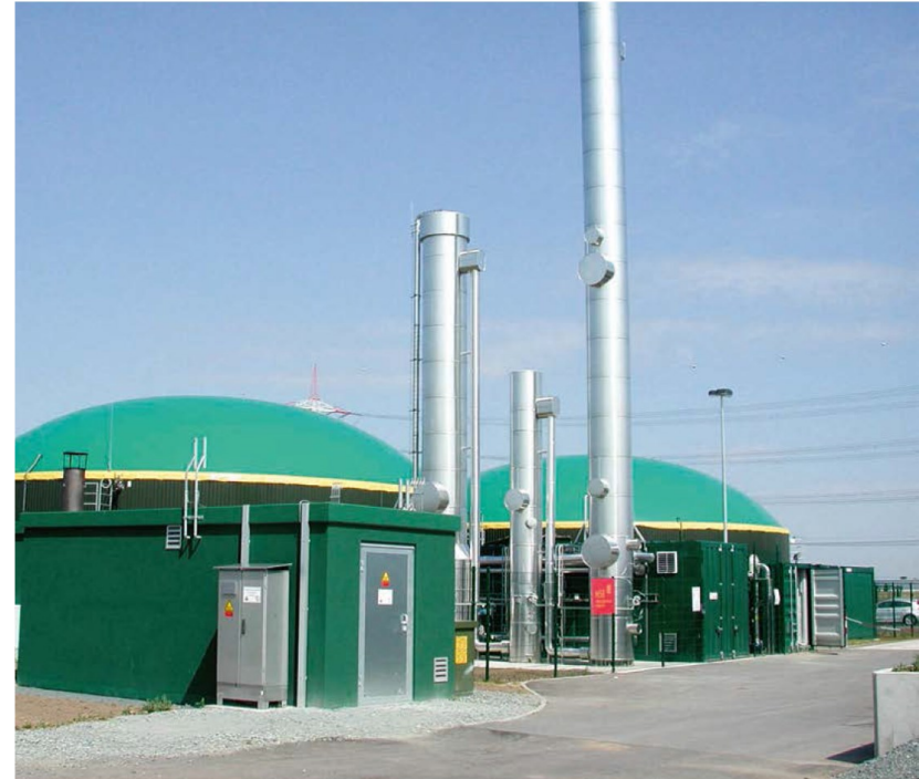
Biogasaufbereitungsanlage. Foto: Fraunhofer IWES / M.Beil
